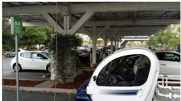
공원 주차장에 위치한 전기자동차 충전
